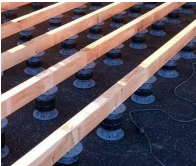
Abb. 15: 2 starre Plattenlager PP155/45 gestapelt, kombiniert mit 2 PLV50/75, Bauvorhaben MPI Tübingen.
